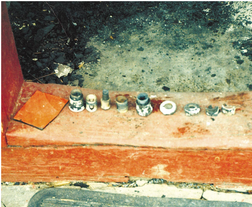
Bezpieczniki spalone w pożarze instalacji elektrycznej
