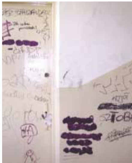
Tak zniszczyli wandalę klatkę schodową w budynku przy ul. Karłowicza 13
